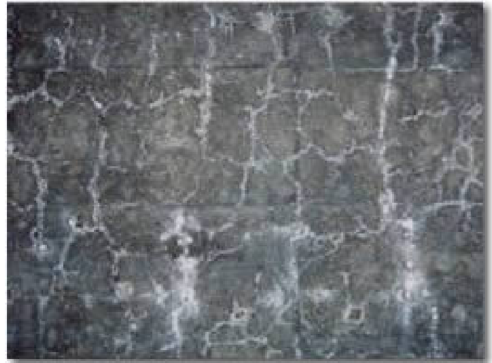
アルカリ骨材反応によるひび割れ(2)
