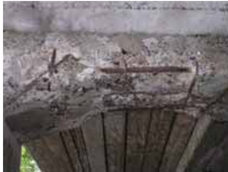
昭和40年架設。RC橋脚に ひび割れ、剥離発生。
