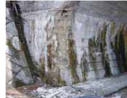
昭和51年架設。トンネル覆 工コンクリートの剥落。鉄筋露出。
