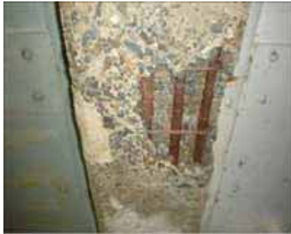
昭和25年架設。桁の劣化。 ひび割れ、剥離発生。
