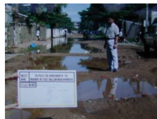
整備前のひどい状態(二輪車は走れない)
