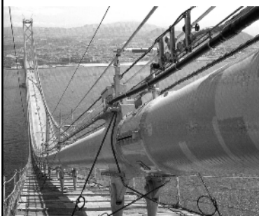
明石海峡大橋 ケーブル空調装置
