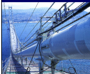
明石海峡大橋 ケーブル空調装置
