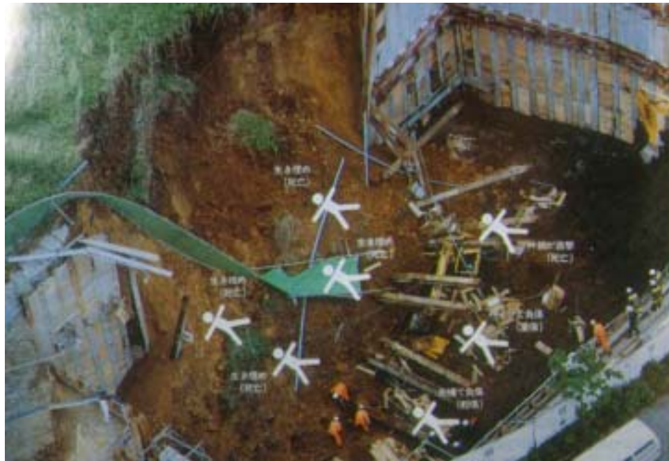
野川健康センター建設土留崩壊 死亡:5名
