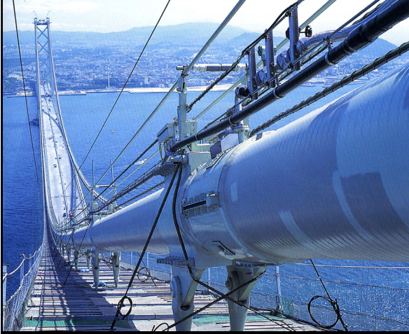
明石海峡大橋 ケーブル空調装置
